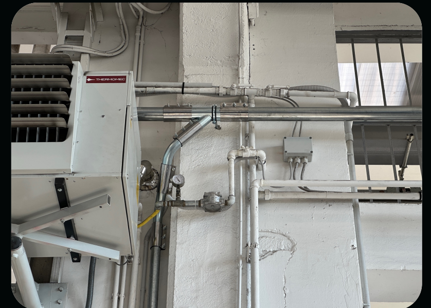
Mehr als 300 Meter Rohrleitungen
