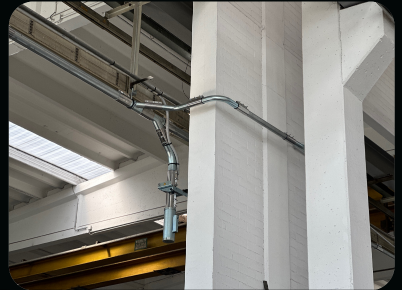
Sistema de limpieza de tuberías incorporado
