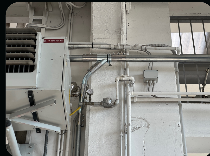
Plus de 300 mètres de tuyauterie
