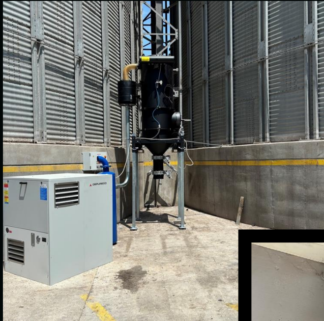
DV-AIR + CVS ROOTS zwischen den Silos
