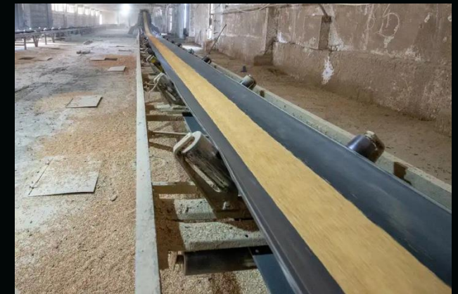
Détail du tunnel du convoyeur à bande
