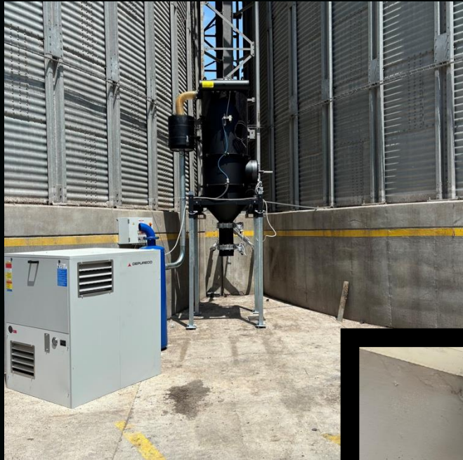
DV-AIR + CVS ROOTS entre les silos
